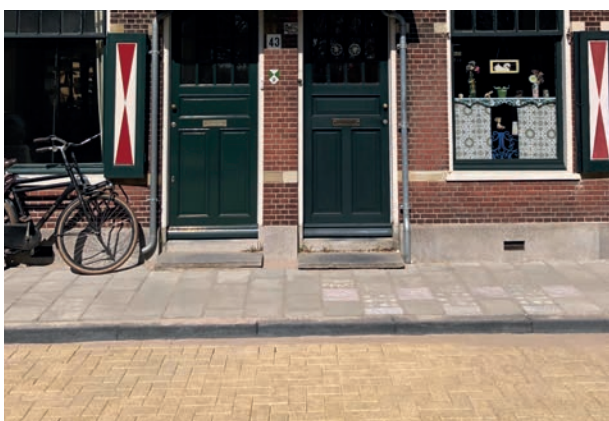
Bloemendaal Mobo betonstraatstenen 21x10,5x8 cm merida geel en betontegels 30x30x8 cm grijs
